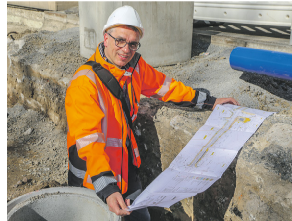
Torsten Zingel vermisst eine Tiefgarage auf der Lockwitzner Straße. Laut den vorhandenen Plänen hätte die viel kleiner sein sollen. Jetzt müssen die Fundamente für die neuen Fahrleitungsmasten anders gesetzt werden.
