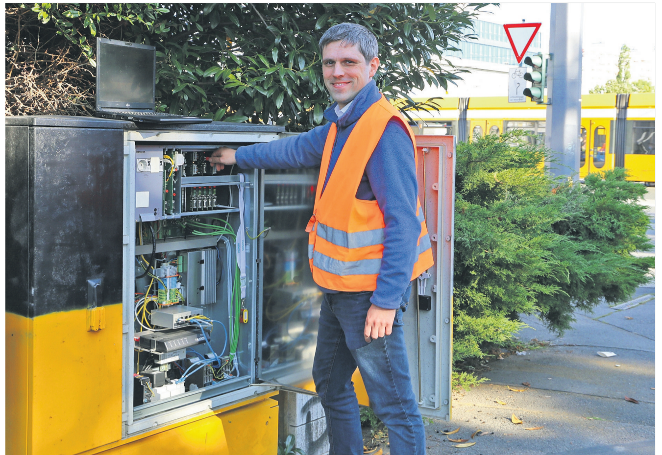
Projektleiter Christian Gassel bereitet den DVB-Teil der neuen intelligente Ampel am Straßburger Platz auf einen Probebetrieb vor. Der soll Ende Oktober beginnen und die Wartezeit für Straßenbahnen an der Kreuzung verkürzen.
