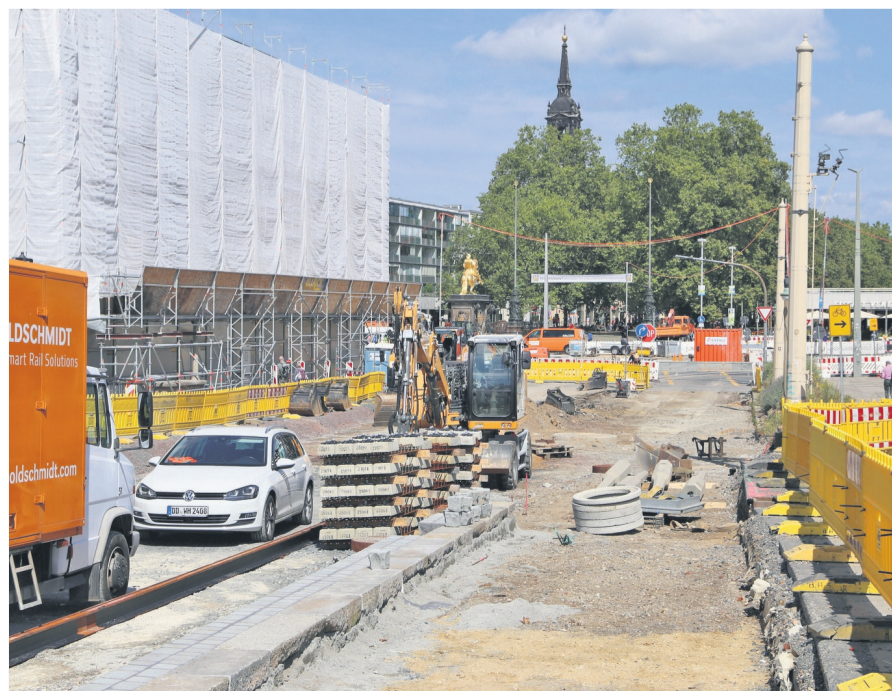
Ab Montag können am Goldenen Reiter wieder Straßenbahnen fahren. Zunächst zwischen Carolaplatz, Neustädter Markt und Leipziger Straße, die Augustusbrücke und alle dort noch fehlenden Gleise sollen bis zum Jahresende fertig werden.
