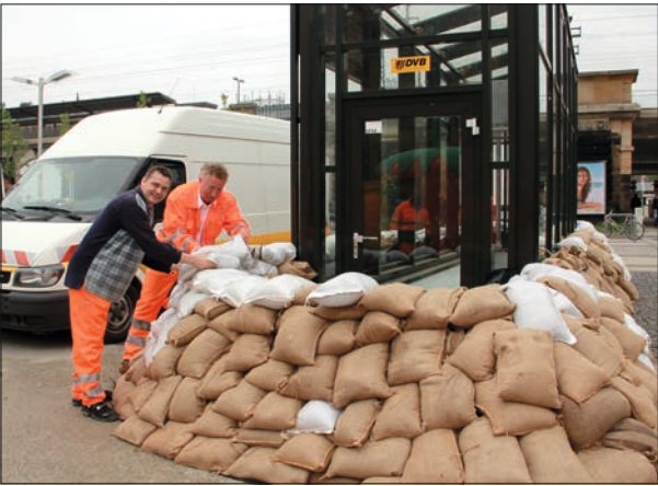
Vier Gleichrichterunterwerke (GUW) mussten im Juni letzten Jahres vor dem Elbehochwasser geschützt werden – hier das GUW am Bahnhof Mitte.
